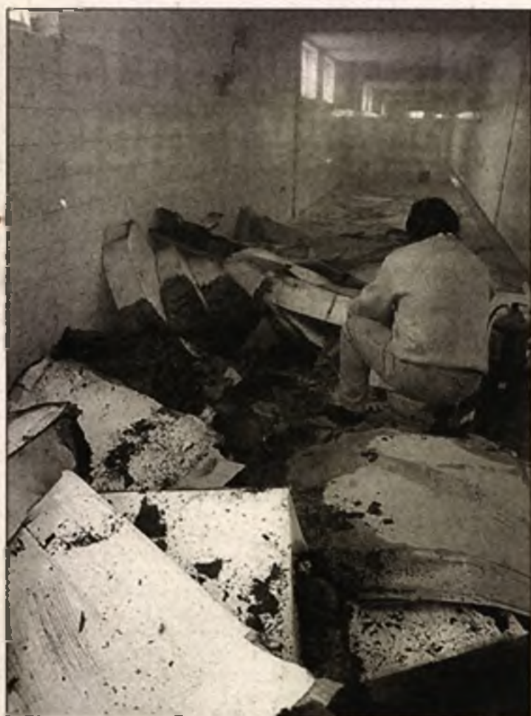
Estado en que quedó la sala en la que se declaró el incendio.
